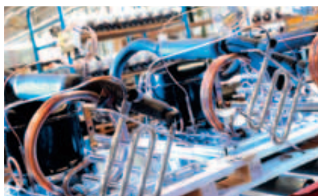
Ligne de chargement / vidange des groupes
